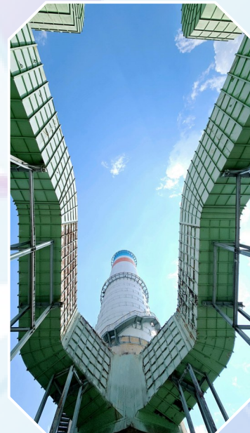
图为云铝涌鑫烟气净化系统排烟管道。 李光 摄
