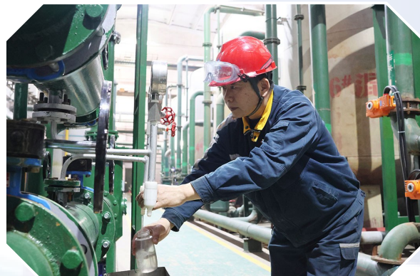
图为中铝山东企业热动力水处理工工进行回水取样。 杨文靖 摄
